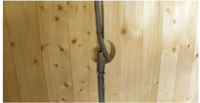
Fig. 51 - Installation de la tuyauterie vide p. ex. avec un tuyau flexible de 25 mm (électrique)
