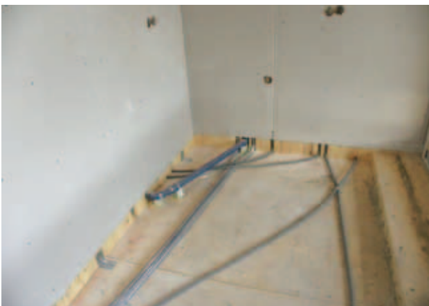
Fig. 68 - Câblage dans le plancher
