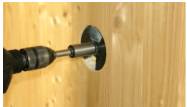
Fig. 49 - Perçage d'une prise de courant dans une paroi en panneaux contrecollés KLH® non visible
