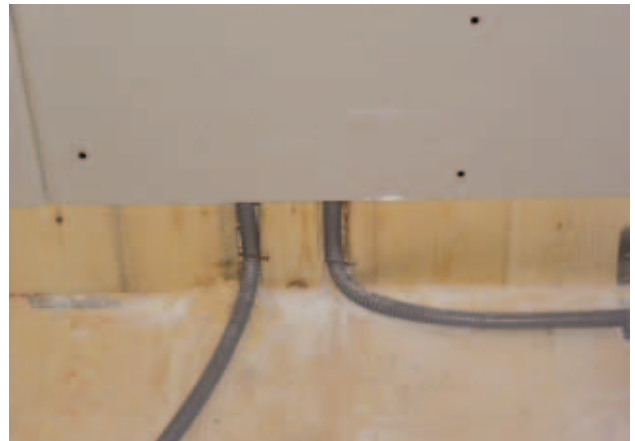
Fig. 67 - Lignes électriques dans le plancher
